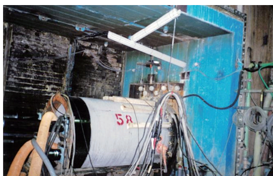
写真-2 ステーション内部
