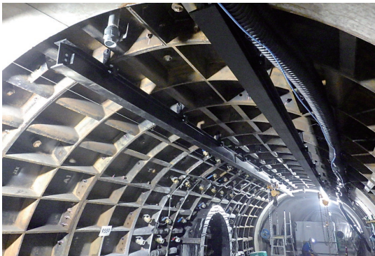
写真-3 坑内吊設備
