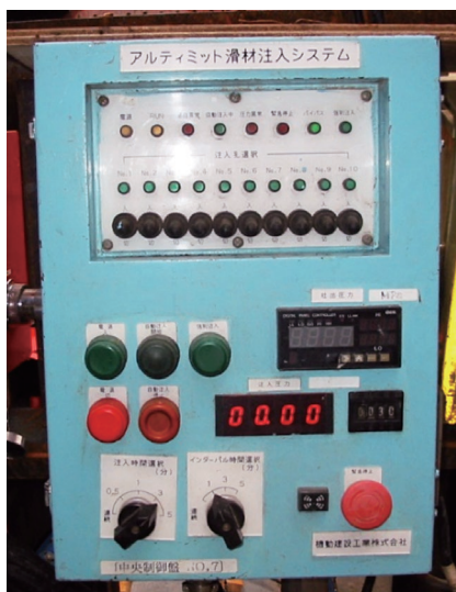
写真-5 初代制御盤
