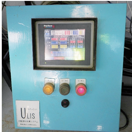
写真-1 中央集中制御盤
