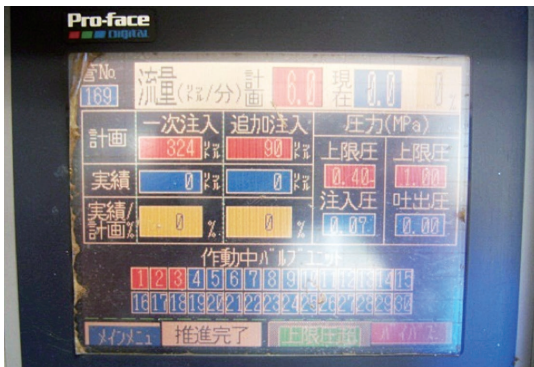
写真-2 中央集中制御盤モニタ
